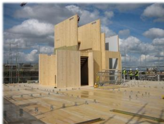
KLH Massivholz GmbH
