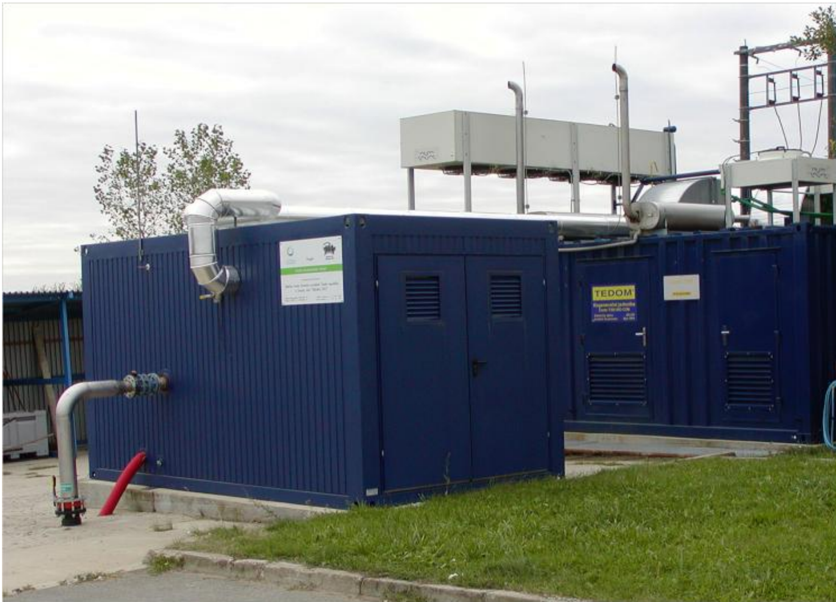
Čerpací a Kogenerační jednotka
